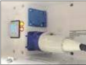
Stromzähler im Schaltkasten
